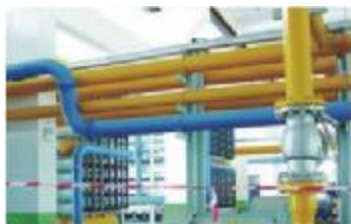
承接岱山县秀山海水淡化项目
